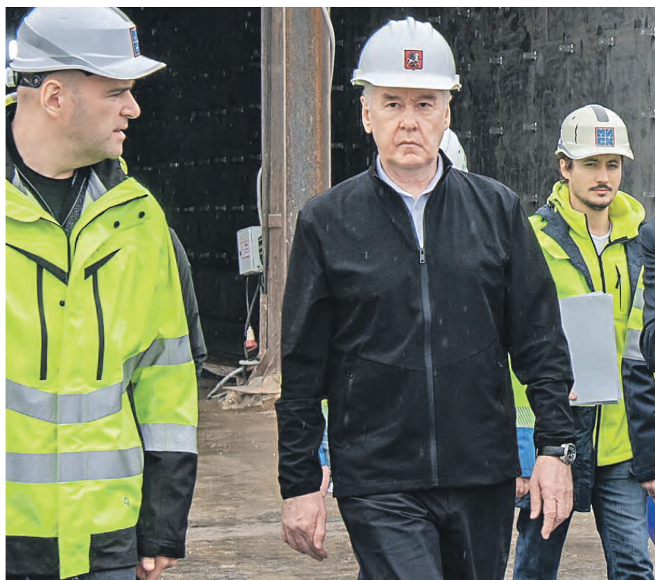
9 апреля. Мэр Москвы Сергей Собянин осмотрел строительство трассы, связывающей МСД с дорогой Солнцево — Бутово — Варшавское шоссе
