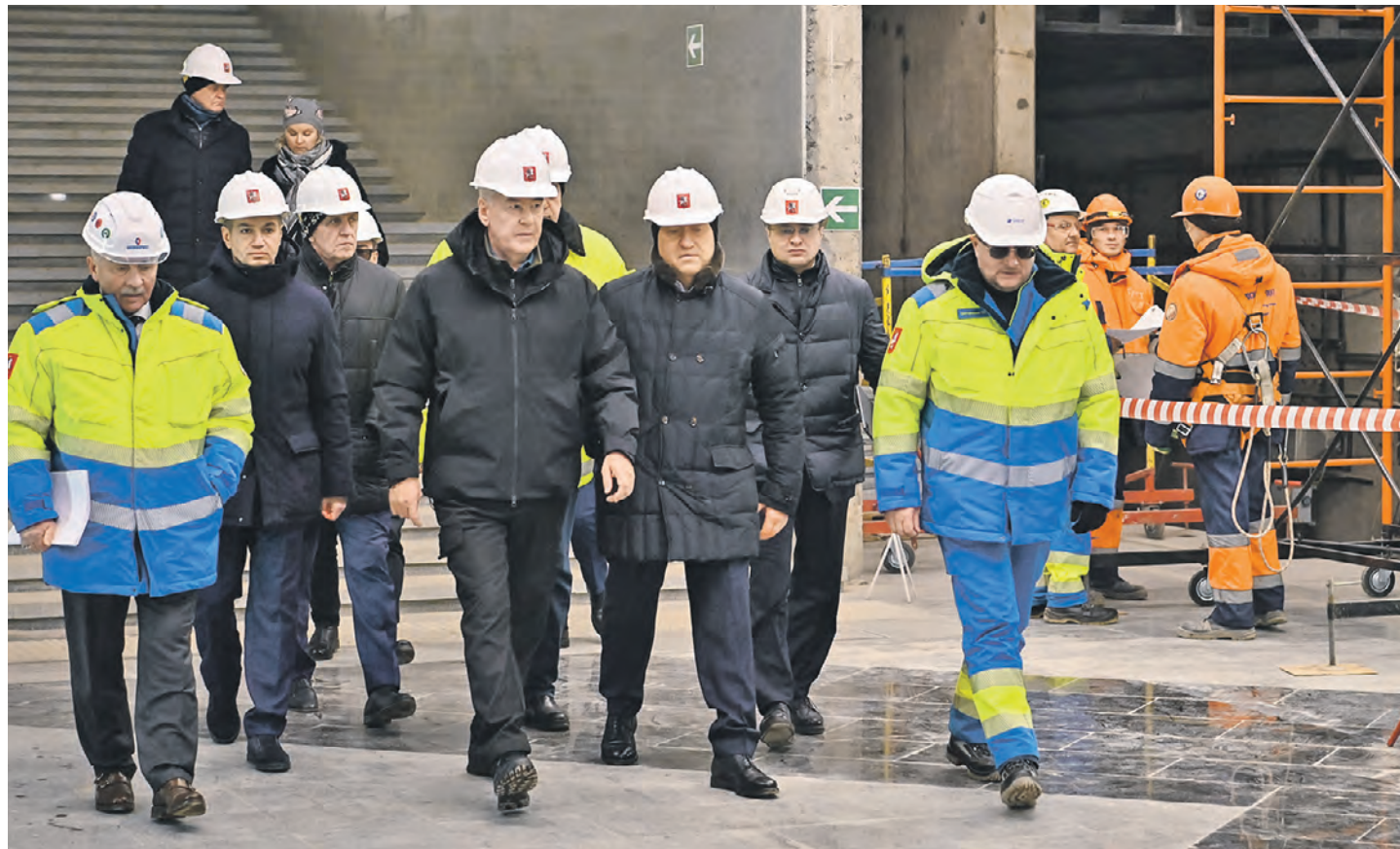
22 ноября. Мэр столицы Сергей Собянин (в центре) и заместитель мэра Москвы по вопросам градостроительной политики и строительства Андрей Бочкарев (справа) осмотрели строящуюся станцию «Тютчевская» Троицкой линии Московского метрополитена
