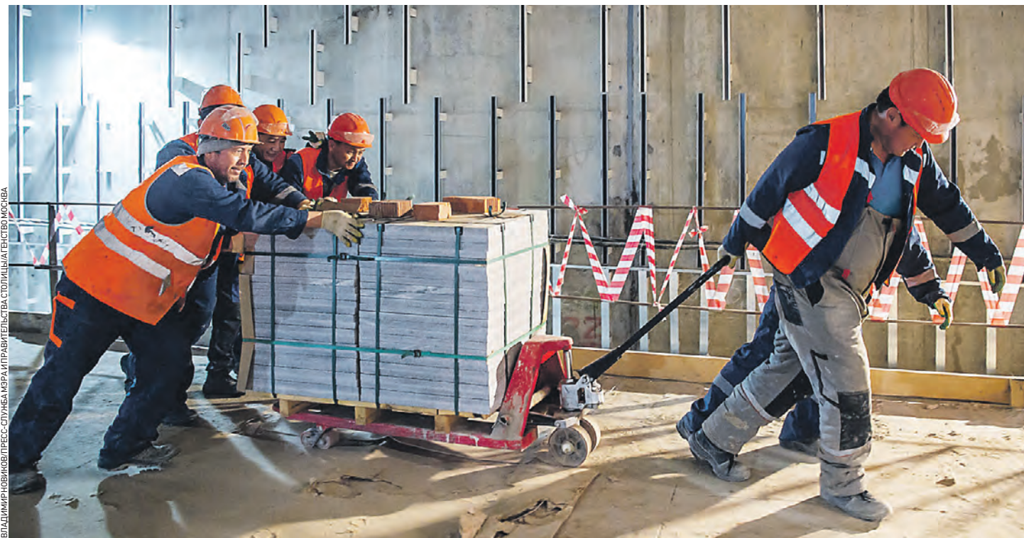
Строительство станции «Университет дружбы народов» Троицкой линии метро продолжается активно. Через несколько месяцев она сможет принять первых пассажиров.
