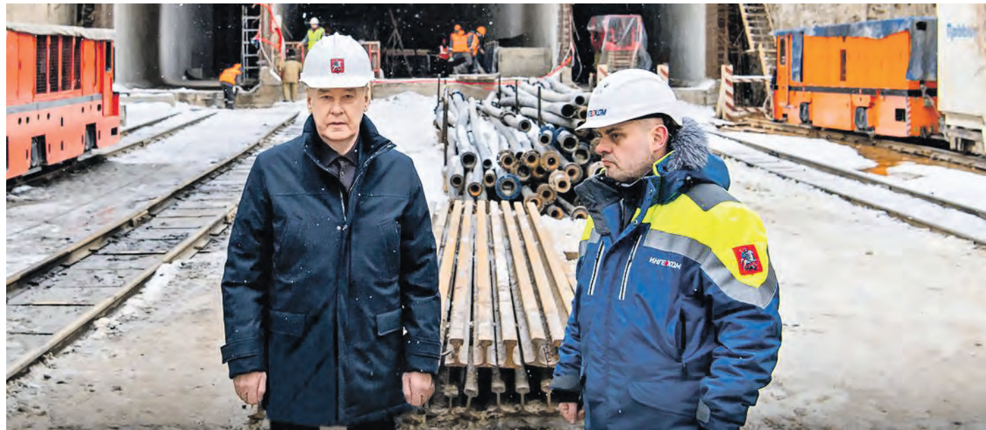
Мэр Москвы Сергей Собянин осмотрел строящуюся станцию «ЗИЛ» Троицкой линии метро. Она, как известно, поможет жителям ТиНАО добираться до центра города быстрее
