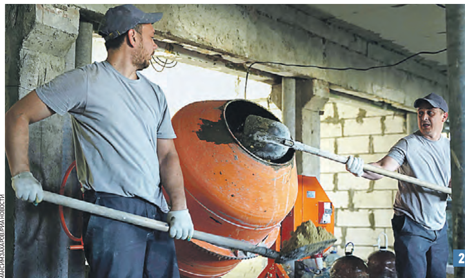
16 сентября 2022 года. Рабочий во время восстановительных работ на Луганской тепловой электрической станции (ТЭС) в городе Счастье (1). Строители на восстановительных работах в общежитии Луганского государственного университета (ЛГУ) им. В. Даля в Луганске (2)
