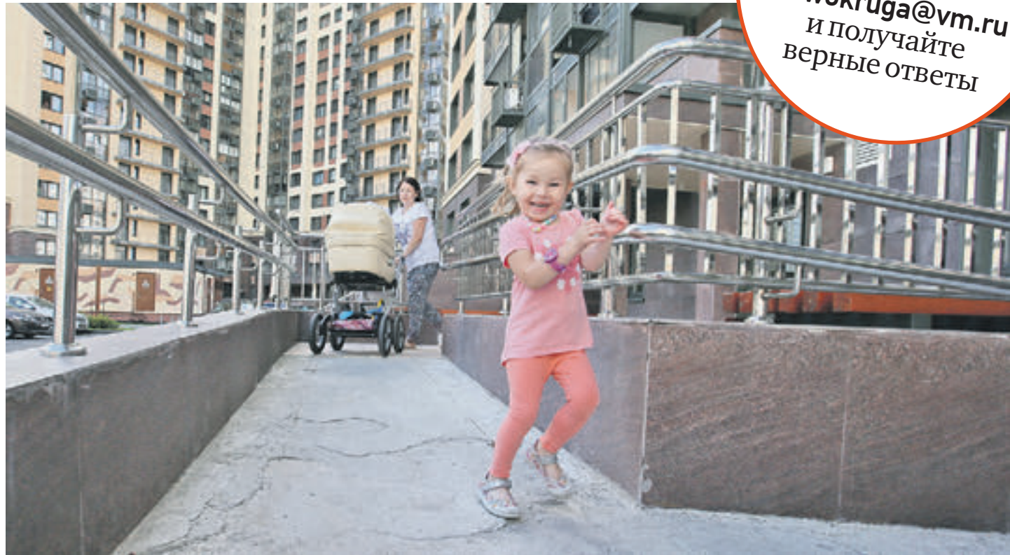
Внуковское. 8 августа 2017 года. Жительница дома № 13 по улице Самуила Маршака Наталья Ржаникова с детьми спускается по разбитому пандусу. Женщину заверили: ситуацию скоро исправят.
