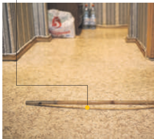
Пол в квартирах неровный. Таким он был с момента сооружения здания. Ситуация могла усугубиться при просадке фундамента в ходе эксплуатации
