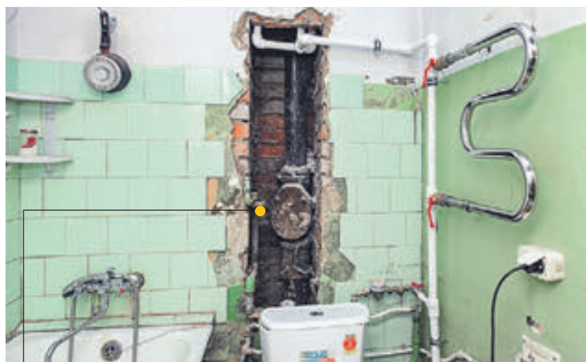
Чтобы заменить трубы в стенах, приходится их раз- бирать. А в некоторых случаях доходит до того, что приходится разбирать перегородки между санузлами разных квартир. Восстановить плитку потом, по госконтракту, невозможно — это не пропустят по смете
