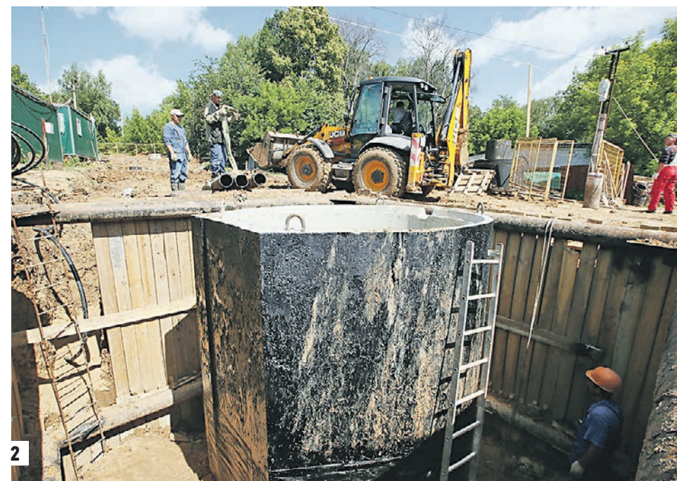
9 июля 2015 года. Поселок Минзаг. После насосной станции (2) сточные воды пройдут несколько стадий очистки в небольшом помещении (1) чтобы затем влиться в реку Пахра
